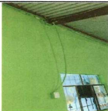
Foto 9: Mejoramiento de sistema electrico principal debido a la sobrecarga del mismo.
