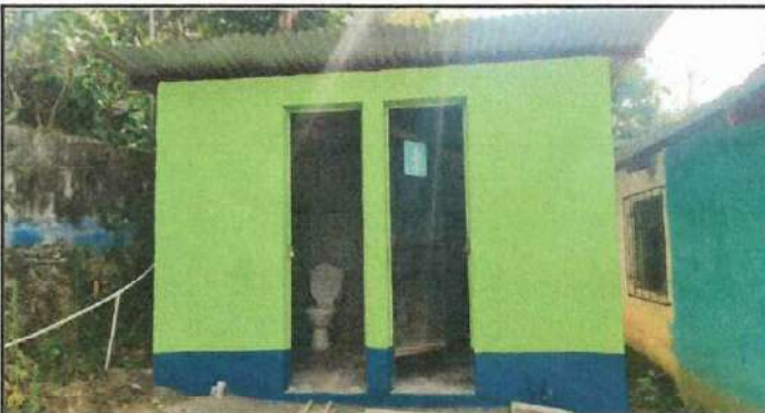
Foto 16: Mejoramiento y ampliación de servicios sanitarios debido a la falta de los mismos.
