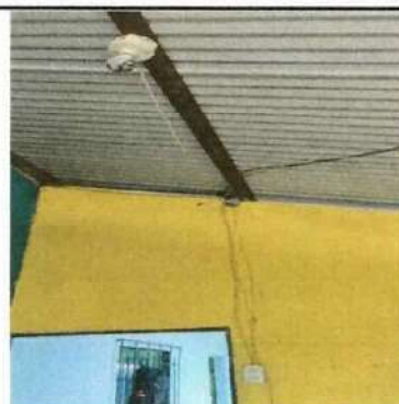
Foto 10: Mejoramiento de sistema electrico principal debido a la sobrecarga del mismo.
