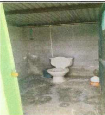
Foto 15: Mejoramiento y ampliación de servicios sanitarios debido a la falta de los mismos.
