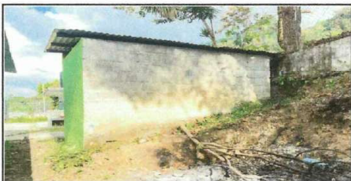
Foto 17: Mejoramiento y ampliación de servicios sanitarios debido a la falta de los mismos.
