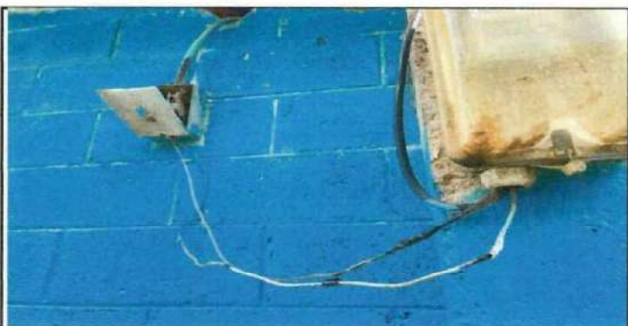
Foto 11: Mejoramiento de sistema electrico principal debido a la mala distribucion del mismo.
